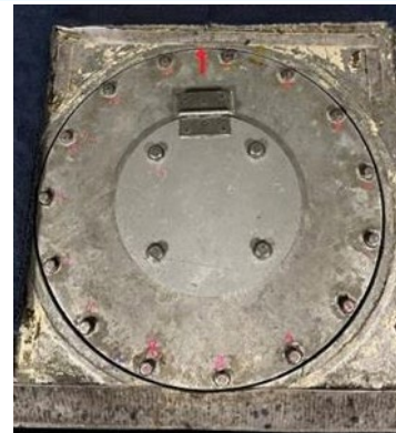
点検口の蓋を締めた状態
