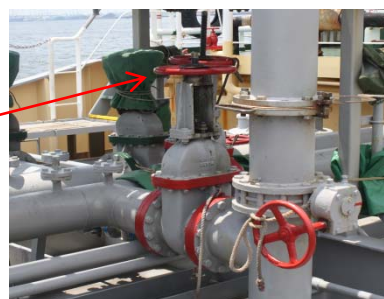
(写真 2.5-5 バイパス弁操作ハンドル)
